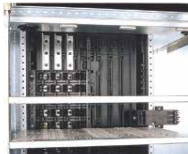
8E/4、8E/2装置小室，电缆和控制线连接（侧出线）
